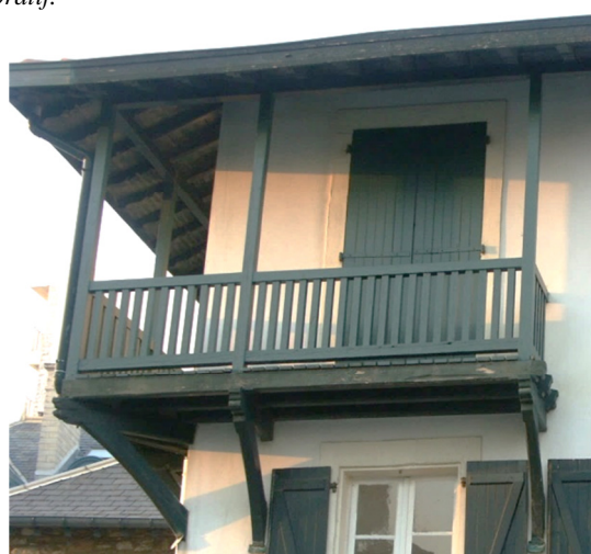
Le balcon à claire-voie peut se présenter sous la forme de simples barreaudages verticaux entre des lisses.
