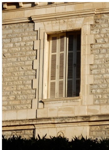
Le volet persienné se développe au début du 20 ème siècle ; il évite de couvrir les encadrements de baies par des contrevents lorsqu'ils sont ouverts
